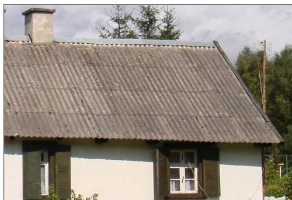
Fot.1 Płyty azbestowo-cementowe faliste
